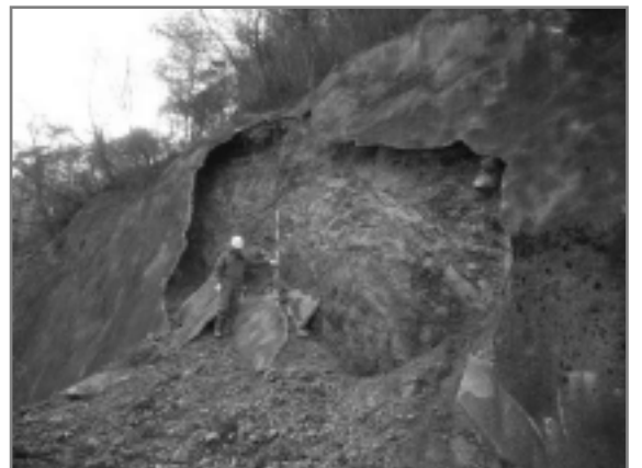
写真2 災害対策施設の破損（吹き付けの崩落）
