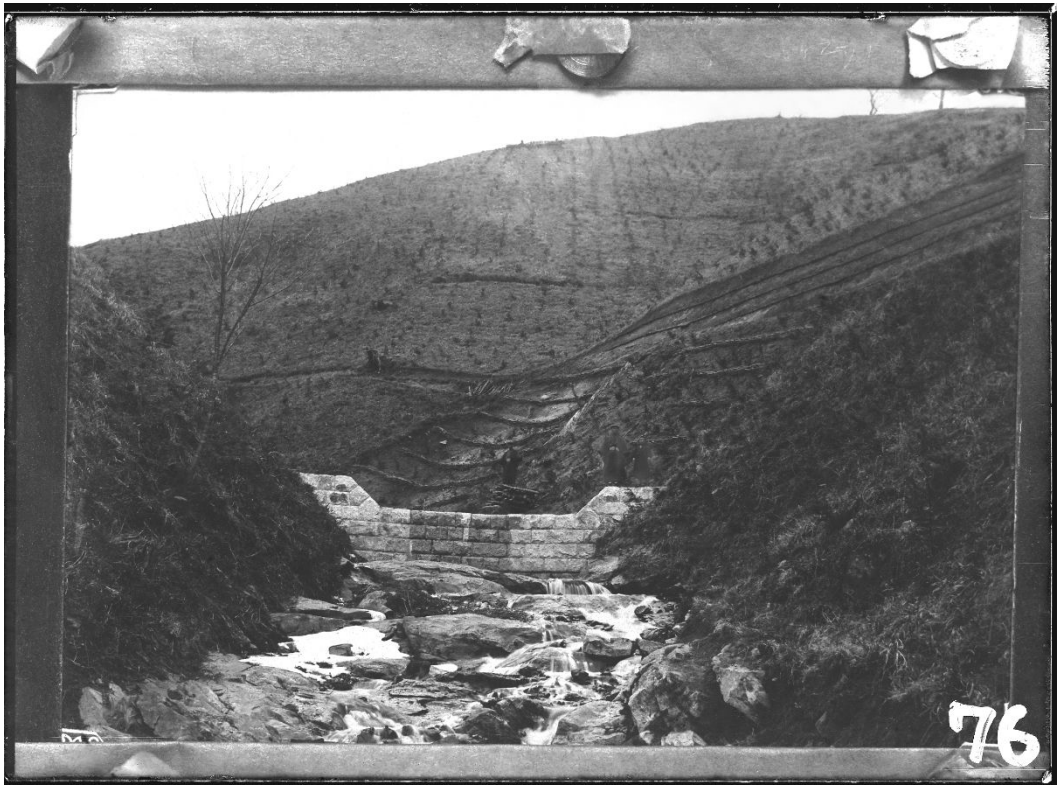
R048 ハビロ沢 石堰堤 大正4年施行(大正5年4月) 【諸戸北郎博士収集写真集 1015 (大正5年11月) と同一写真】 【「砂防」口絵写真集 S39-1 と同一写真】
