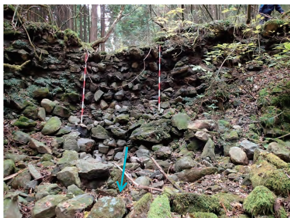
図 2-2-16 堰堤⑨の本堤破損状況 (平成 29 年 11 月 30 日撮影)
