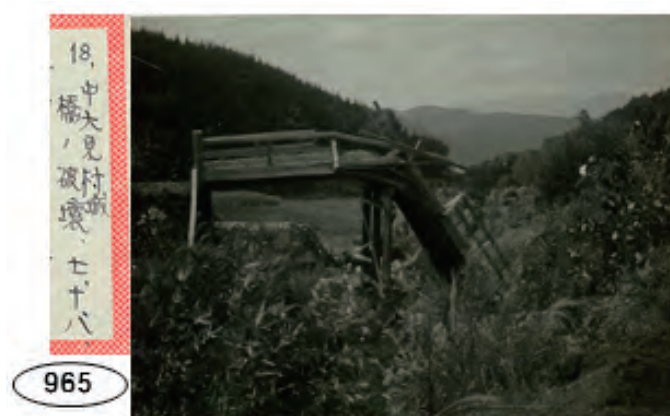
隆起によって破壊した橋 (昭和6年2月9日撮影) [諸戸北郎博士アルバム]
