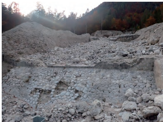
図 3-3-19 前面の勾配が緩く被災している堰
