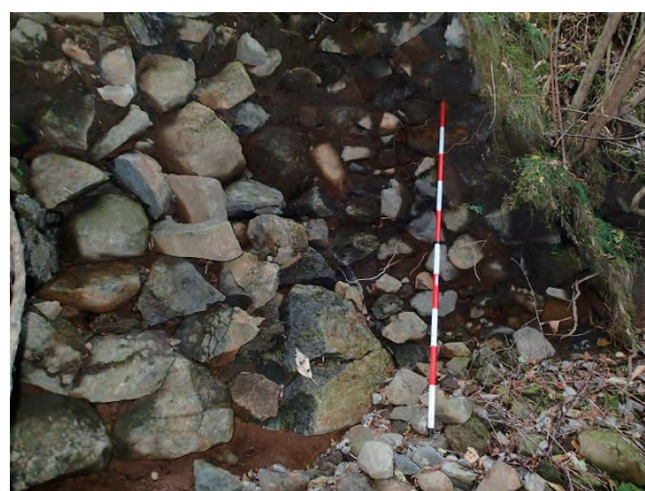
図 2-2-19 左写真の破損状況 (平成 29 年 11 月 30 日撮影)
