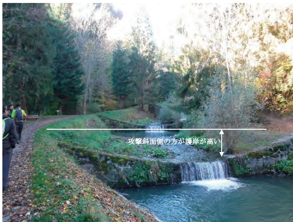
図 7.4-6 上流の床固工（湾曲部）
