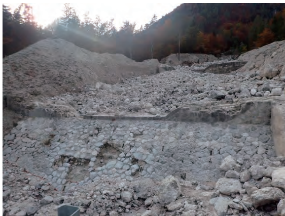
図 3.3-6 施設前面の勾配が緩く被災している
