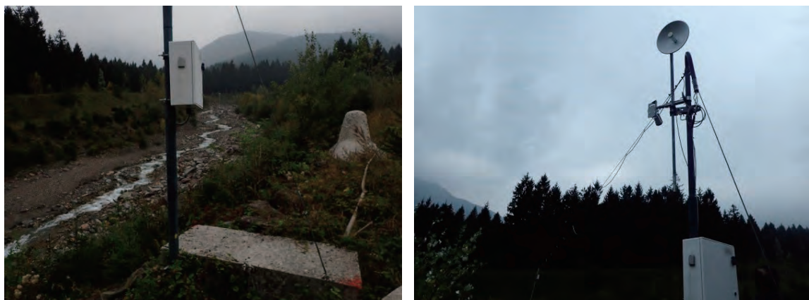
図 4.3-18 下流側センサー設置状況
