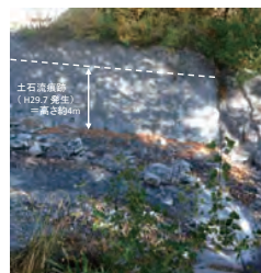
護岸工に確認できる土石流痕跡
