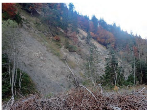
図 3.2-13 堰堤下流部左岸側：崩壊が進む
