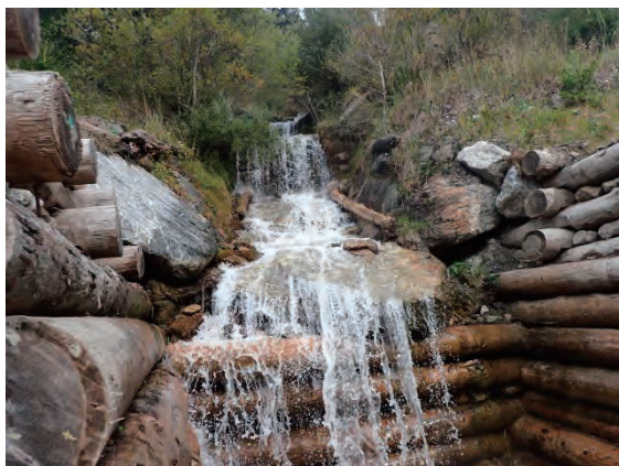
図 4.3-11 支川の木製堰堤
