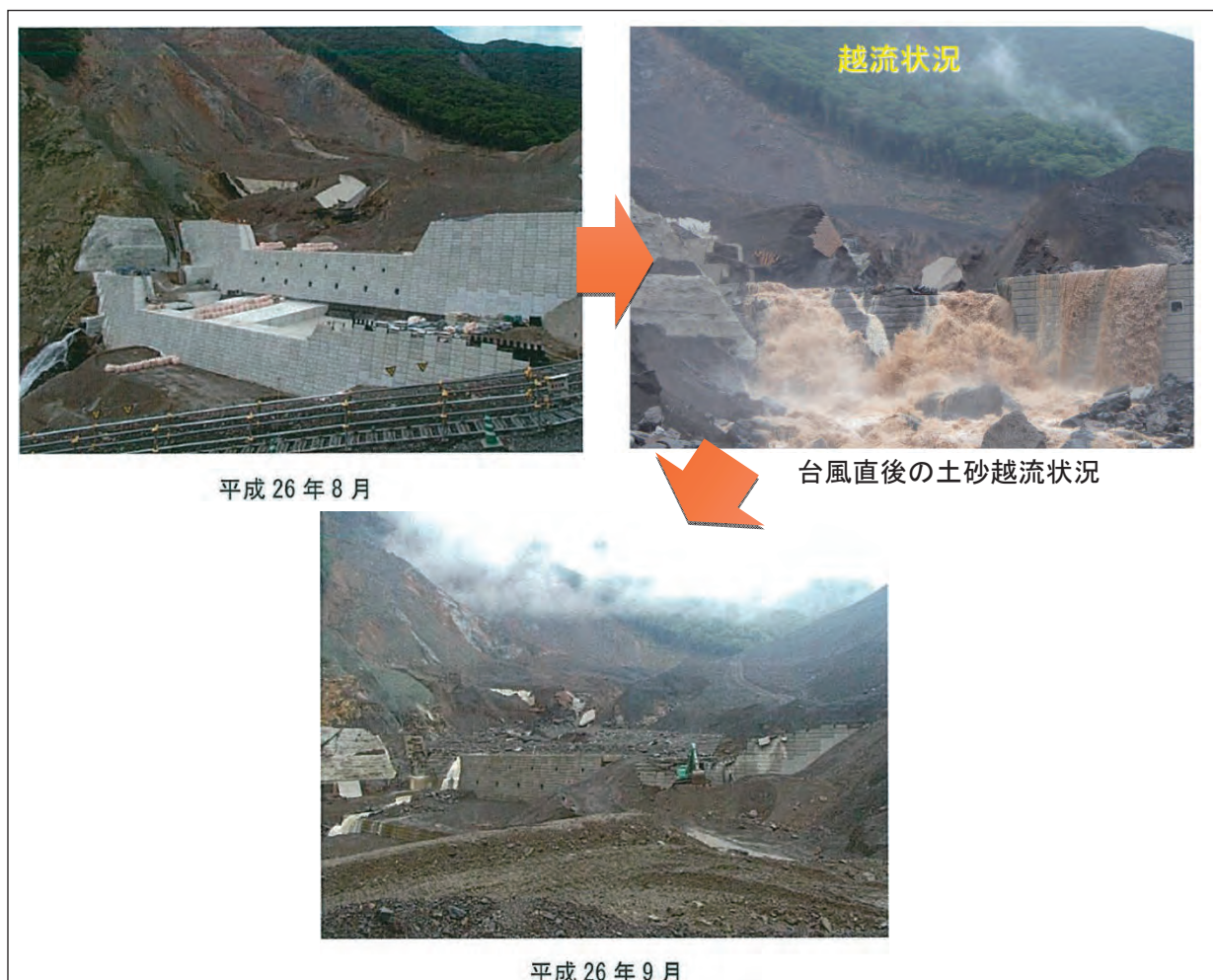
写真 6.13 平成 26 年台風 11 号の被災前後の状況(平成 27 年度実践実習報告より)
