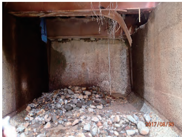
一部、損傷した様子も見られた。
