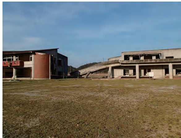
大川小学校の破損状況
