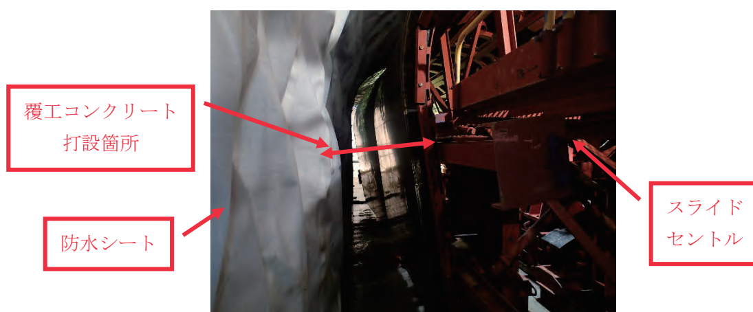
図 2.3.5 仮排水トンネル内部のスライドセントル
