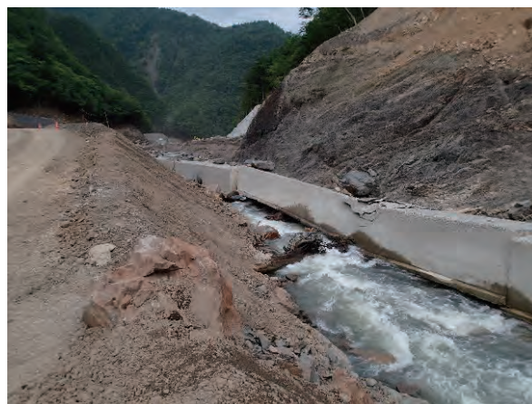
写真 6.16 暗渠工周辺の侵食 (平成 27 年度実践実習報告より)
