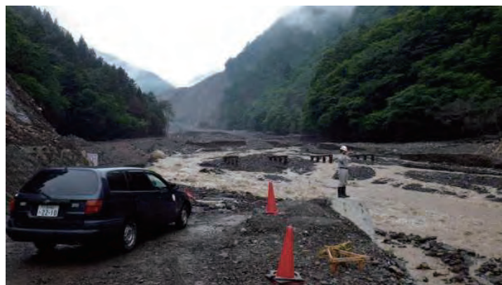
写真 3.9 仮排水路工への土砂流入状況(鹿島建設提供資料より)
