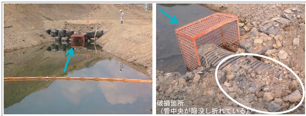
写真 6.7 暗渠工破損状況(平成 25 年実践実習報告より)
