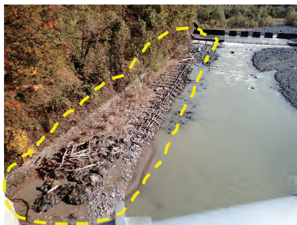
図 2.1.6 木工沈床の露出状況
