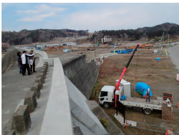
破壊された防潮堤
