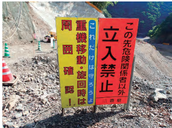
写真 5.22 重機侵入看板
