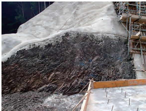
写真 6. 24 右岸袖部の露岩状況 (平成 28 年度実践実習報告より)
