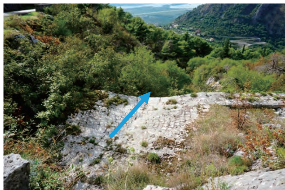
石積堰堤越流部の状況
