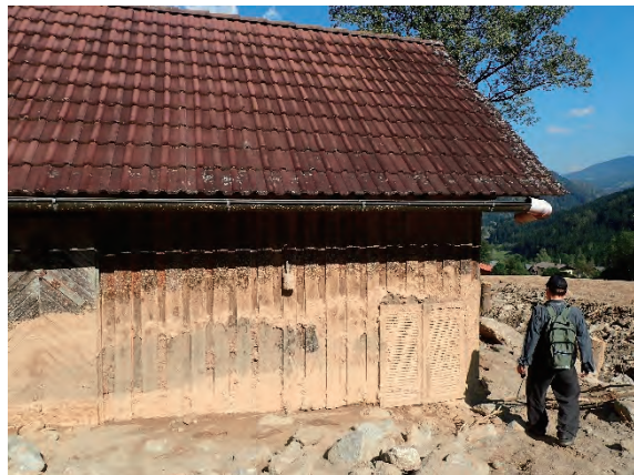
土石流が直撃した小屋
