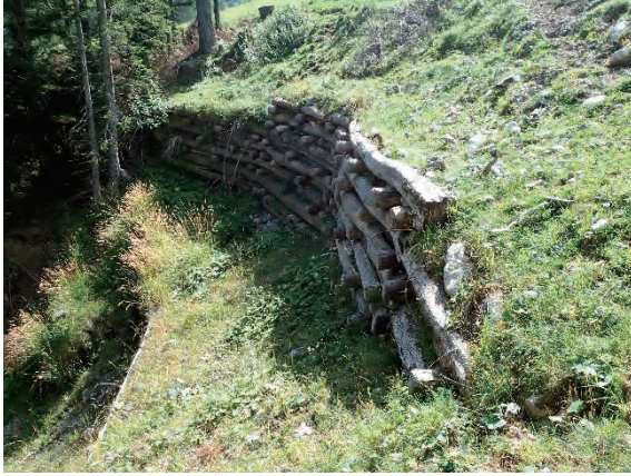
木製の山腹基礎工
