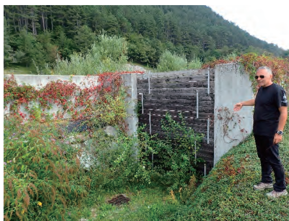
支溪にある除石用車両進入口
