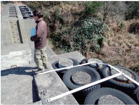
針原川・堰堤袖部の古タイヤ緩衝材
