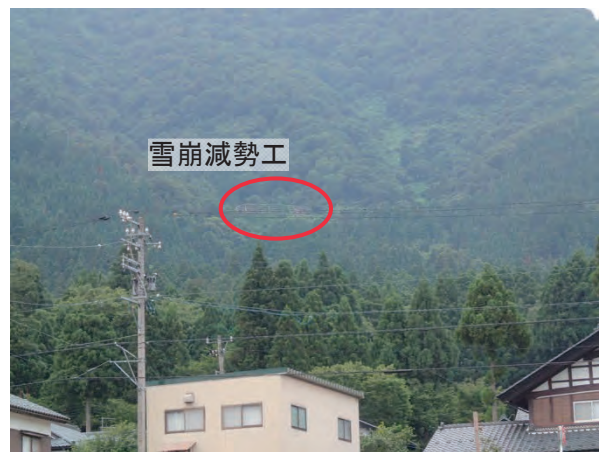
写真 2.3.5 飯降地区雪崩減勢工 (平成 28 年 7 月 12 日撮影)
