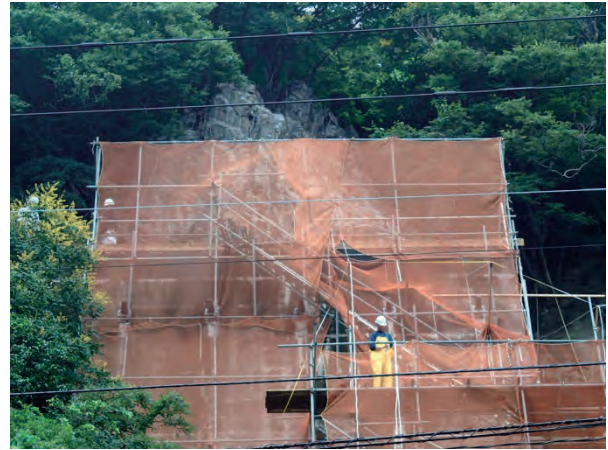
写真 2. 15. 6 覆式落石防護網 (平成 28 年 7 月 15 日撮影)
