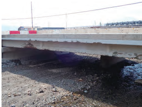
深港橋の損傷状況
