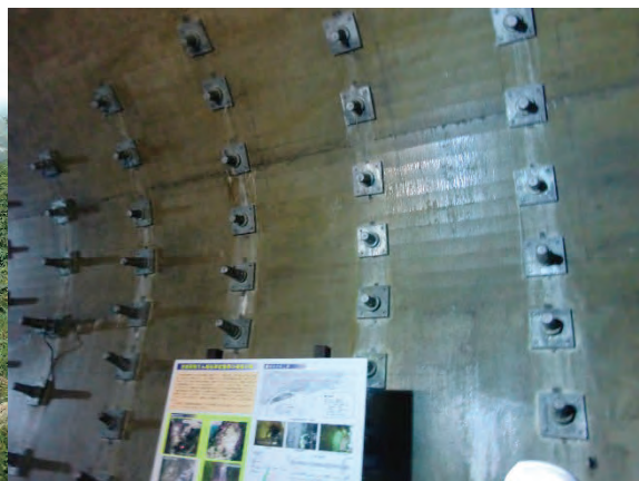
トンネル内のアンカー受圧板
