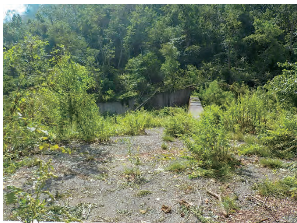
昭和川沈砂池
