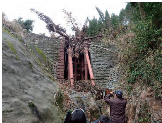
磯脇川での流木捕捉状況
