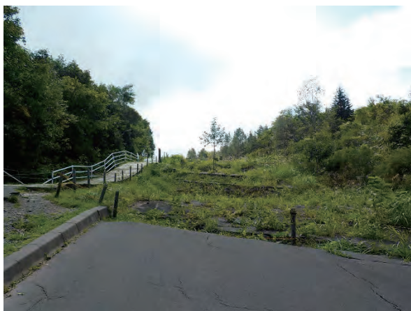
陥没した散策路上のグラーベンの様子
