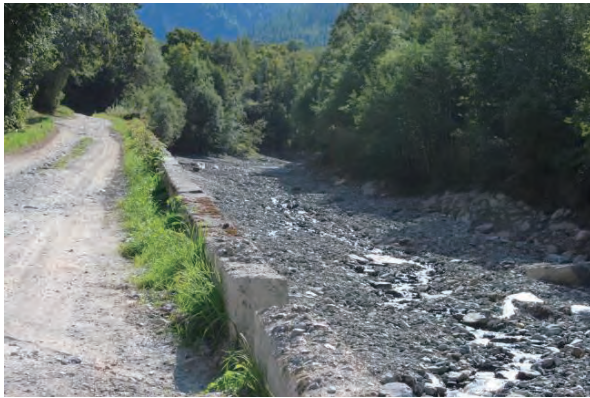
Griaz 溪下流部の状況 (護岸天端に 2015. 7. 19 土石流の痕跡)
