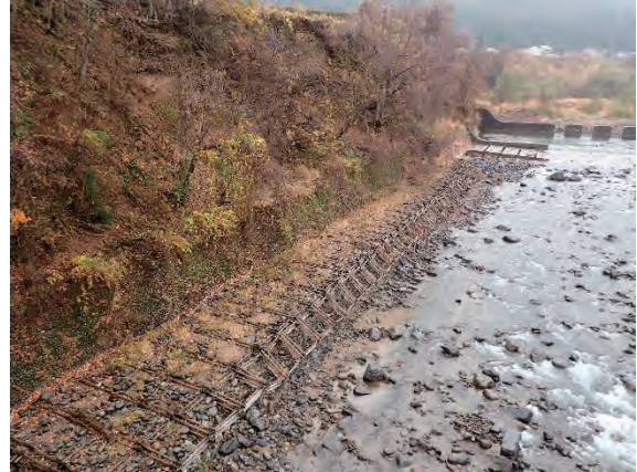
右岸河床低下の状況
