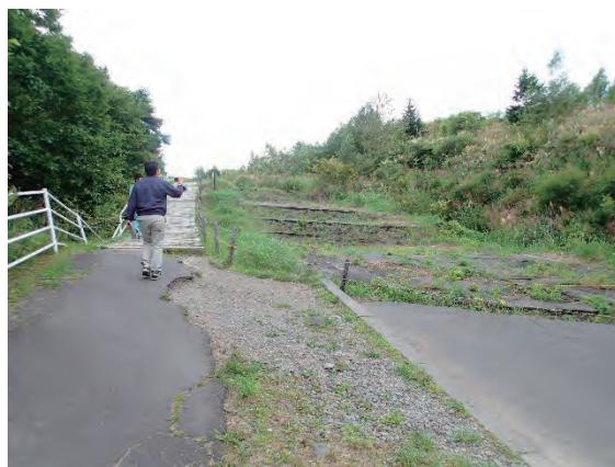
隆起した町道
