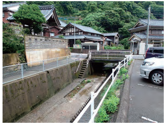
H10 当時に被災した箇所 の 現況
