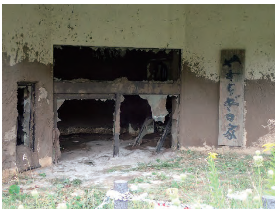
被災した公営浴場
