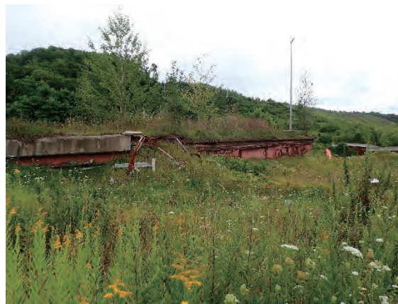
約 150m 上流から流された橋
