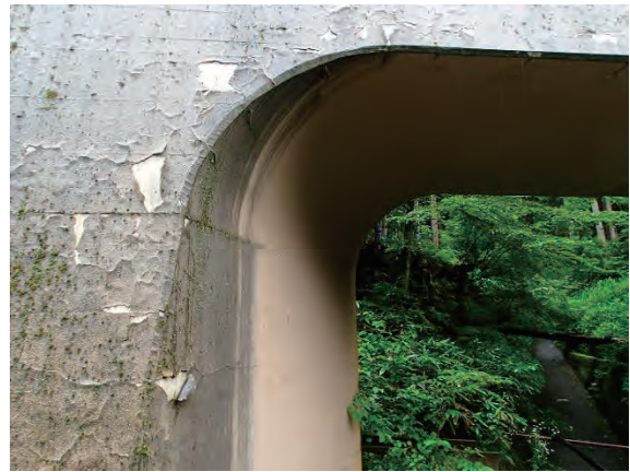
樹脂吹付工の剥離状況
