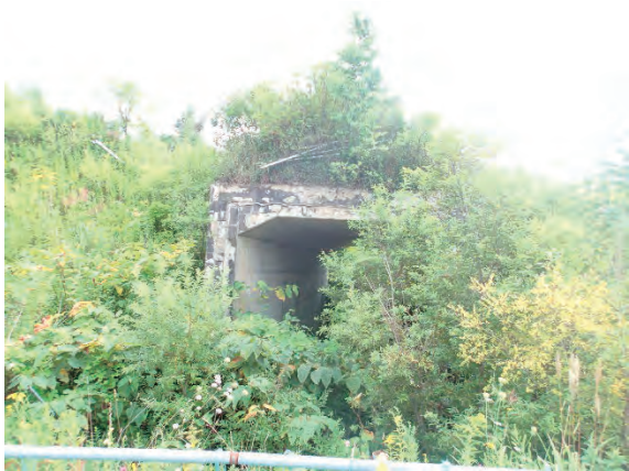
7m 隆起したカルバート
