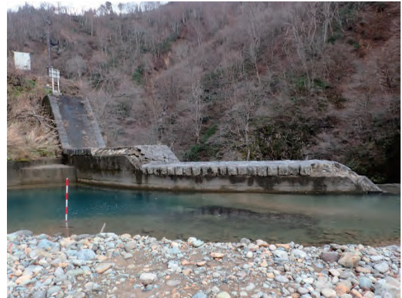
左岸水通しの一部破損状況
