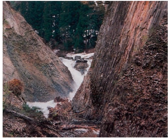
一番滝（右岸崩壊後） 2)
