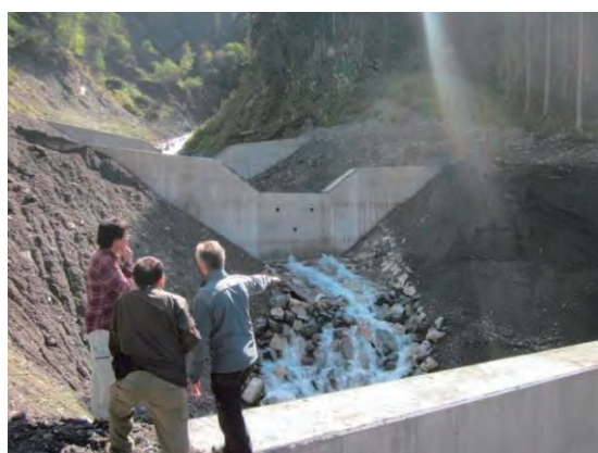
不透過型堰堤の配置状況
