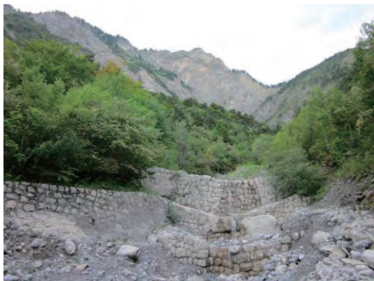
上流の崩壊地と堰堤の状況
