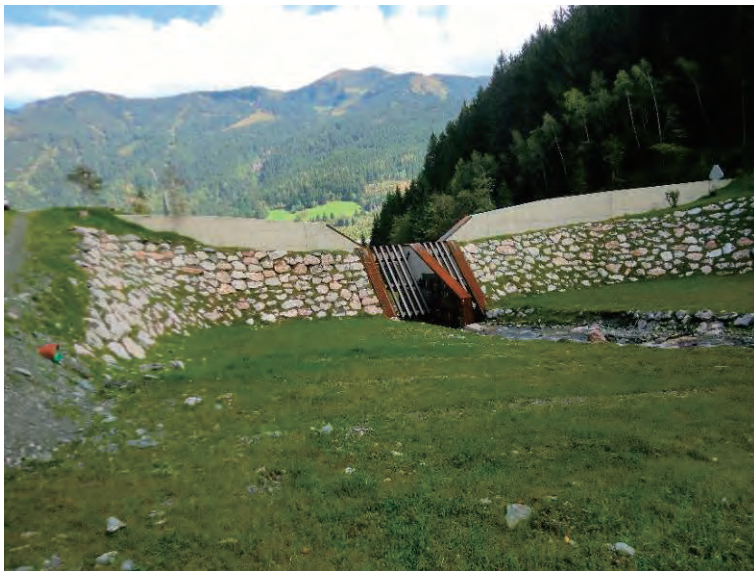
透過型鋼製スリット堰堤
