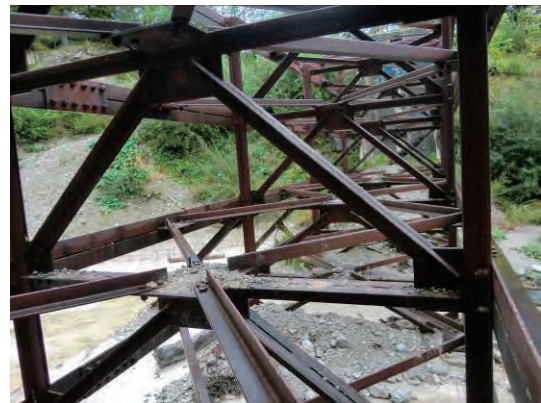
鋼製砂防堰堤 (堤体鋼材部)
