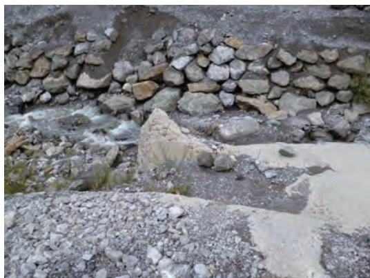
流失した砂防堰堤
