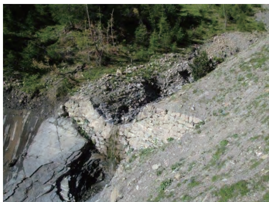
既設砂防堰堤の水叩き部の損傷状況
