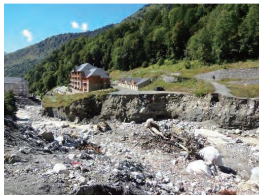
溪岸の侵食状況
