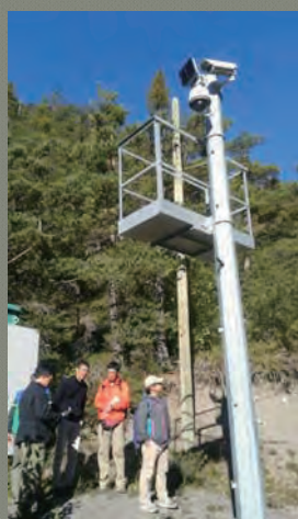
監視カメラおよび通信機器
