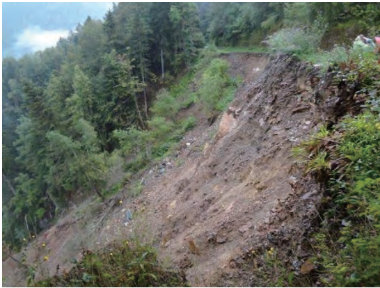
地すべり源頭部の状況
