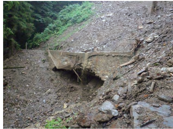
谷止工の被災状況
