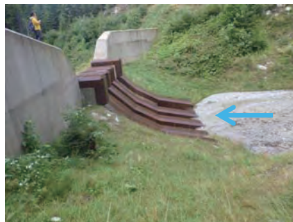
写真-2 スリット側面の状況
