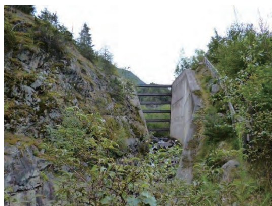
横スリット型の透過型堰堤
