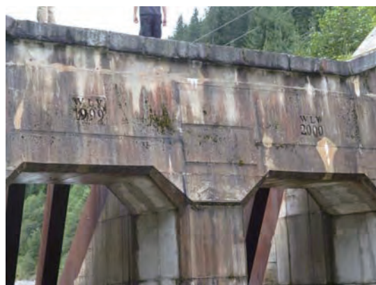
水通し下流面の張出状況
