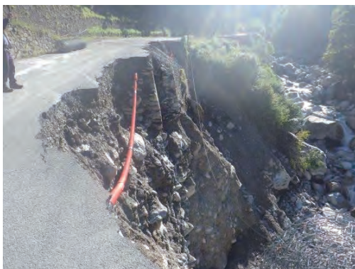
溪岸の侵食状況(上流域)
