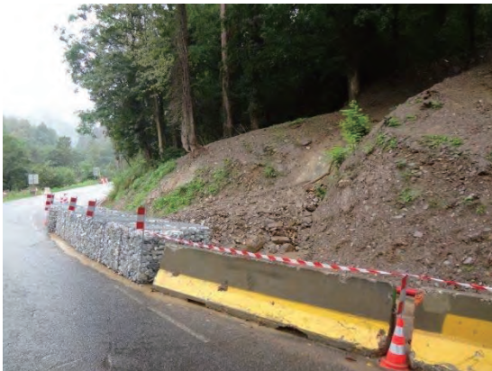
土砂が流出氾濫した道路
