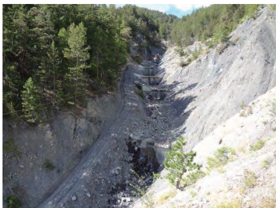
溪岸侵食状況と堰堤配置状況
