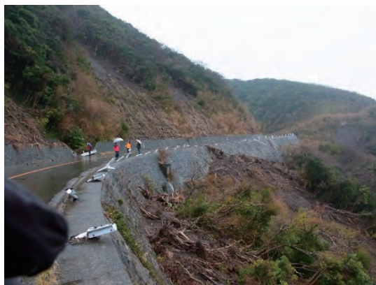
崩壊土砂により支柱が転倒している様子
