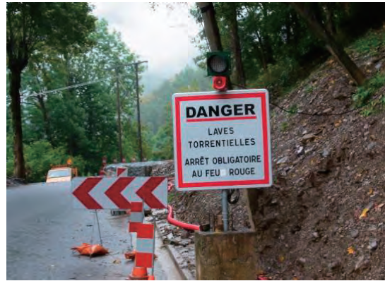
山腹崩壊による土石流で被災した道路の 注意喚起看板
