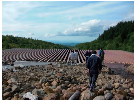
富良野川 4 号底面スクリーン堰堤
