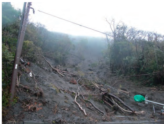
御神火スカイラインより山側の崩壊地を望む
