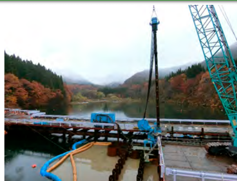
大源太堰堤(湯沢砂防)
